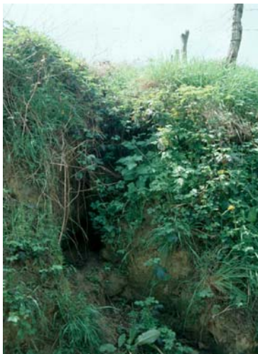
Erosiegeul door waterafvoer.
